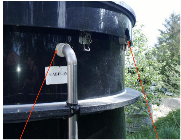
Kabelgennemføring til teknikkasse
